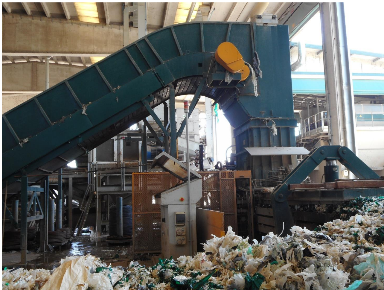
Figura 8-4 - Impianto recupero plastiche
