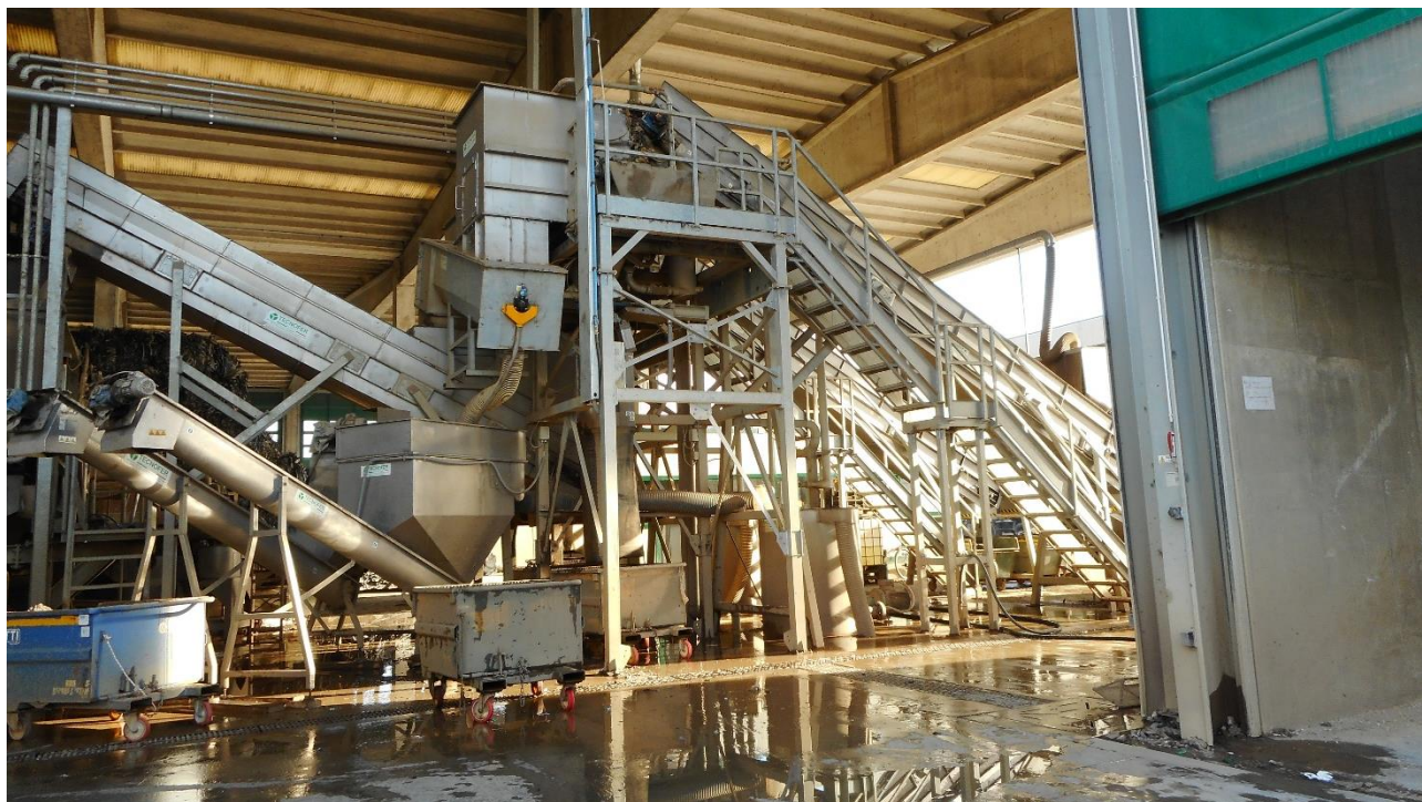
Figura 5-3 –Impianto Lavaggio Plastiche
