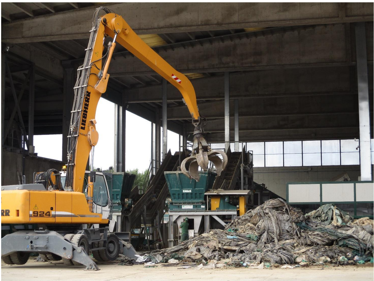
Figura 5-3 – Nuovo Impianto Lavaggio Plastiche operante in regime semplificato – Linea 6 – 4 Settembre 2017
