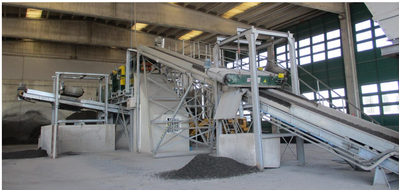
Figura 5-3 - Impianto di demetallizzazione - settembre 2015
